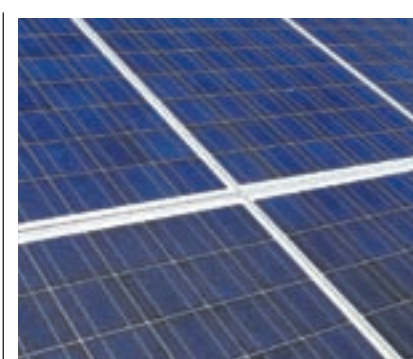
Energía limpia. Placas fotovoltaicas.
